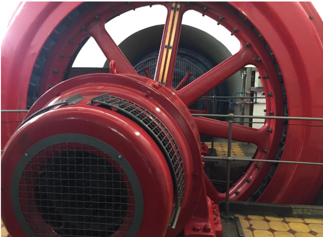
Abb. 4: Dreh- und Gleichstromgenerator im KW Rieden Alt
